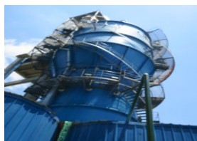
「循环流化床」锅炉
