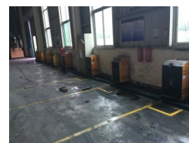
电动叉车充电桩
