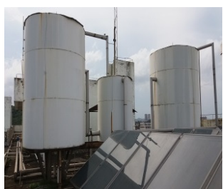
太阳能系统保温水箱
