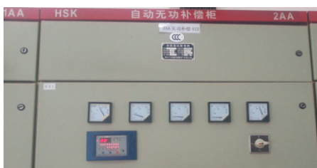
设于现场的电容补偿柜
