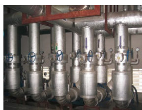
冰蓄冷空调管道
