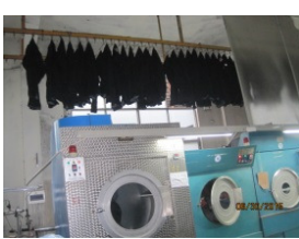
烘干机上部吊挂系统
